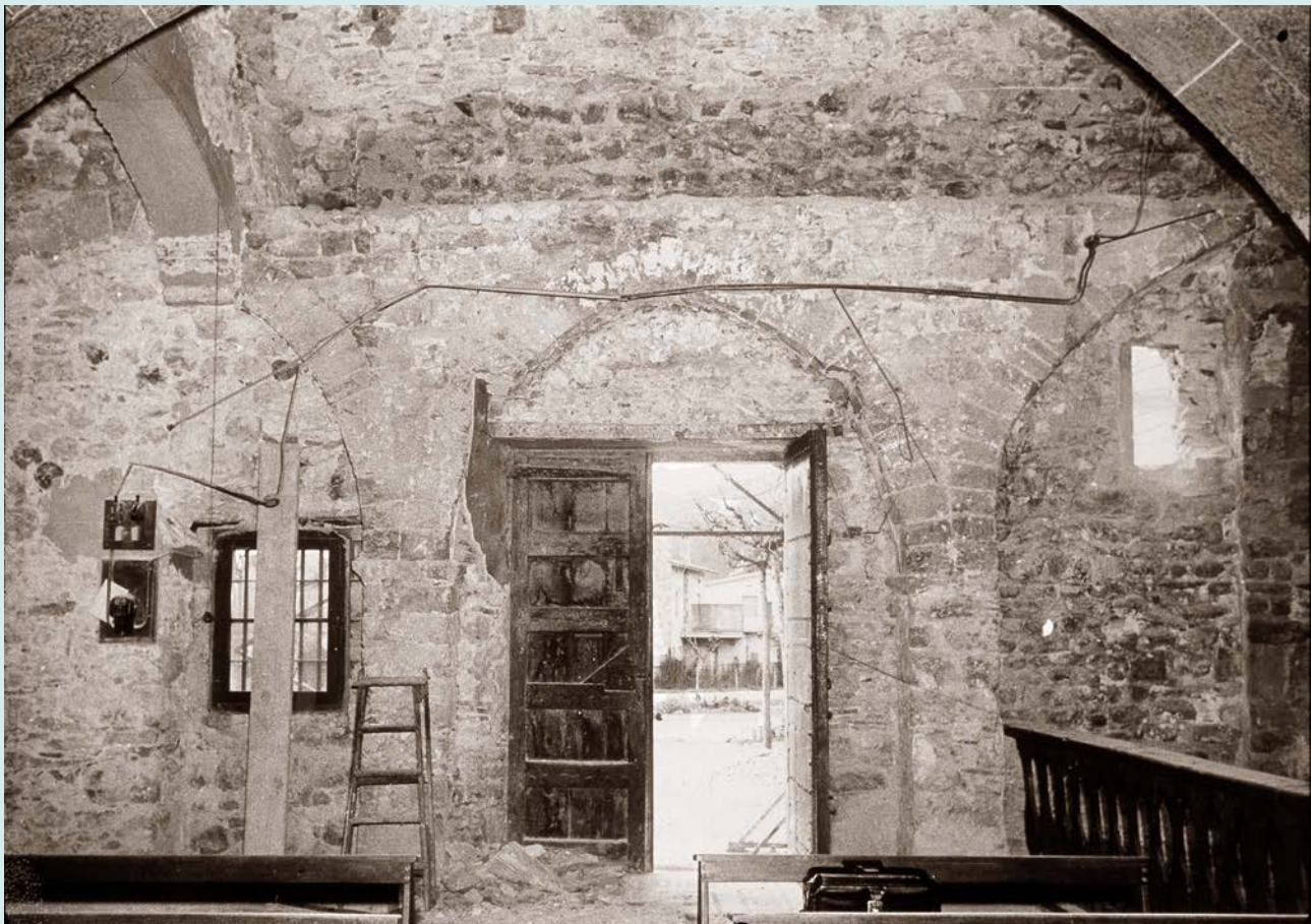
Alçat i imatge de l'interior del mur sud. S'hi pot veure, a la dreta, la primera porta i, al mig, l'actual. També hi veiem l'arcuació que s'adossà a l'interior del mur on es recolzava la volta de canó apuntat. Dibuix: Pere Cuní. Fotografia: SPAL. Diputació de Barcelona. 1965
